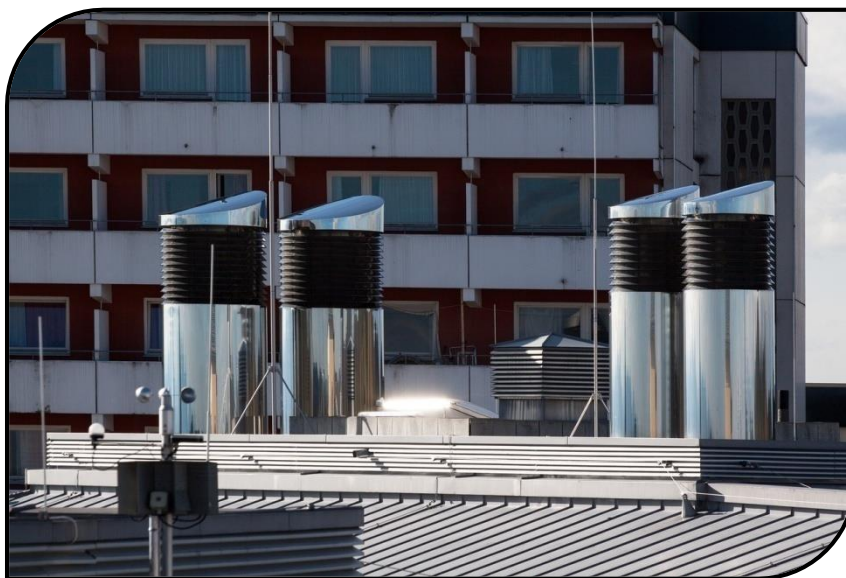
Сл.3.59. Канали за вентилација
