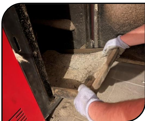
Сл.3.74. Чистење на котел на пелети
