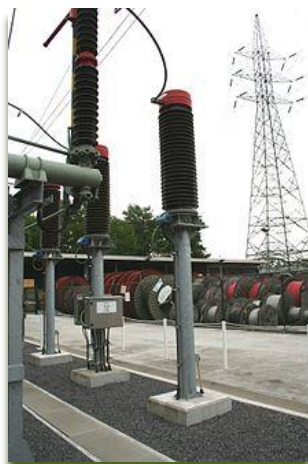
Fig. 4.2: Transformatori matës i tensionit
