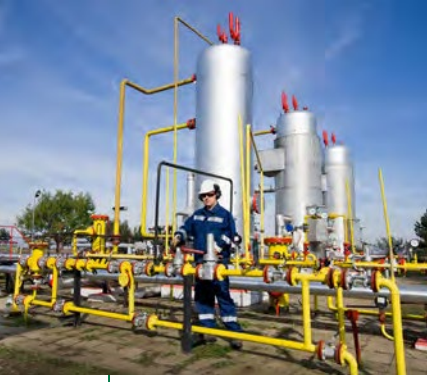
Doğal gaz taşıma tesisi
